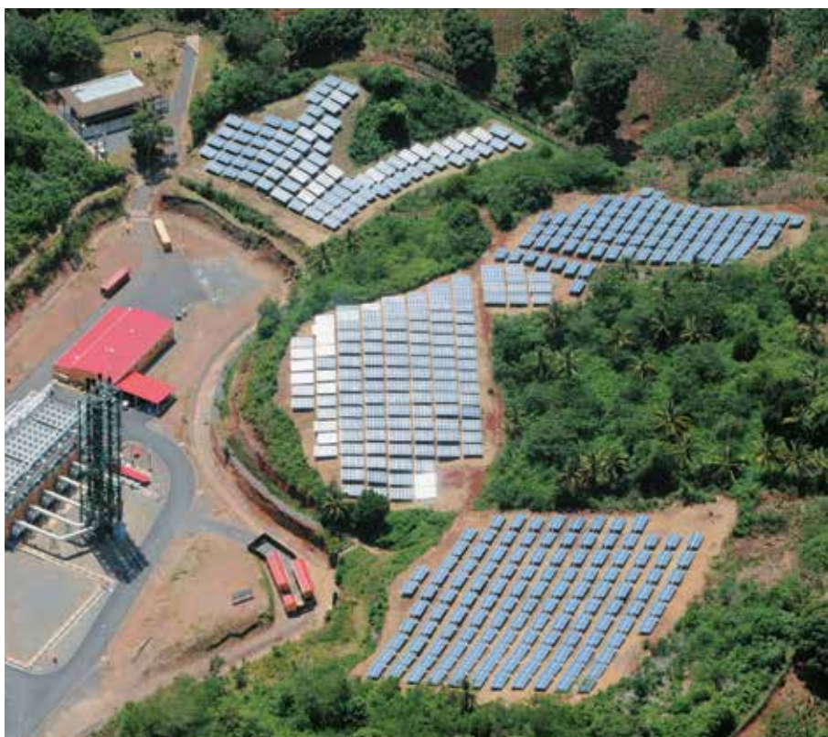
Mayotte. Centrale de Longoni. © EDM
